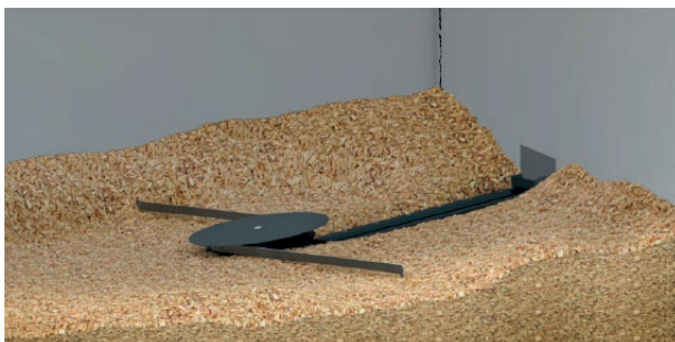
Fig. 4 Lagerraum mit Rührwerk
